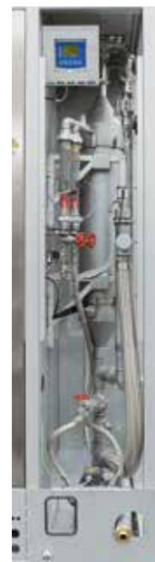
Abgaswäscher für die Reinigung entstehender Prozessgase durch Auswaschen
